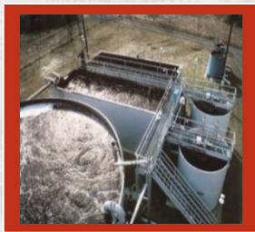
سیستم بازچرخانی آب
